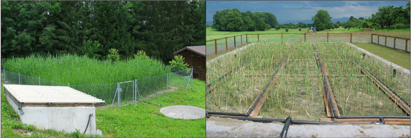
Abb. 3+4: Pflanzenkläranlage mit Rottebehälter (links vorne) und Schilfbeer für ein Zweifamilienhaus. (Abb. © BiCon AG Kreuzlingen). Frisch bepflanzter Vertikalfilter einer 45-Einwohner-Kläranlage. (Abb. © BiCon AG Kreuzlingen)
