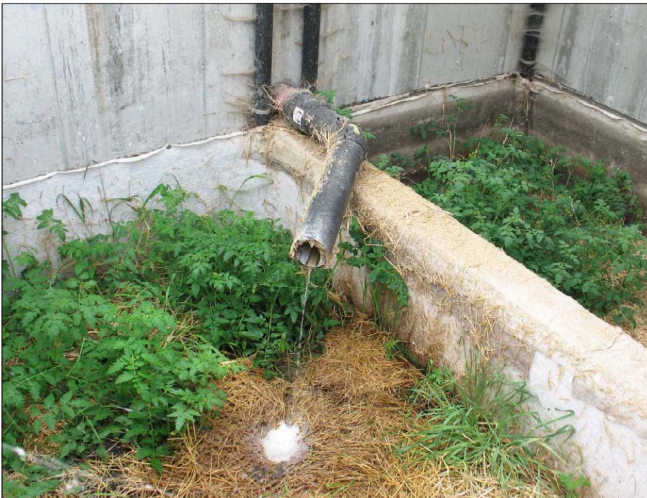
Abb. 6: Im Rottebehälter werden die Fäkal-Feststoffe abgefiltert und kompostiert. (Abb. © BiCon AG Kreuzlingen) Fig. 6: Les matières fécales sont filtrées et compostées dans le bac de rouissage. (Fig. © BiCon AG Kreuzlingen)
